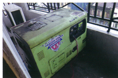
[写真3] 自家発電装置は事務所に必須
