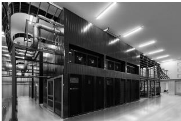
■図2-8-4 ABCIシステム外観
